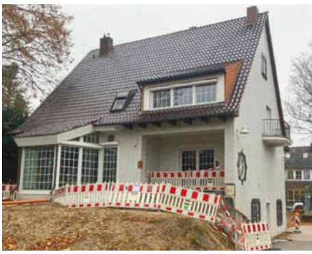
/ Das Einfamilienhaus vor der intensiven Sanierung: Eine gute Grundsubstanz macht dies erst möglich.
